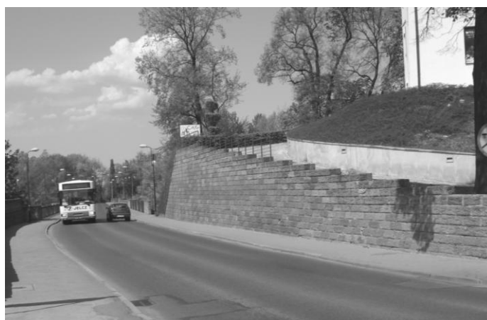
Rys. 3. Mur oporowy od strony ulicy (zdjęcie: B. Piotrowicz). Fig. 3. The retaining wall from the street side (photo by B. Piotrowicz).
