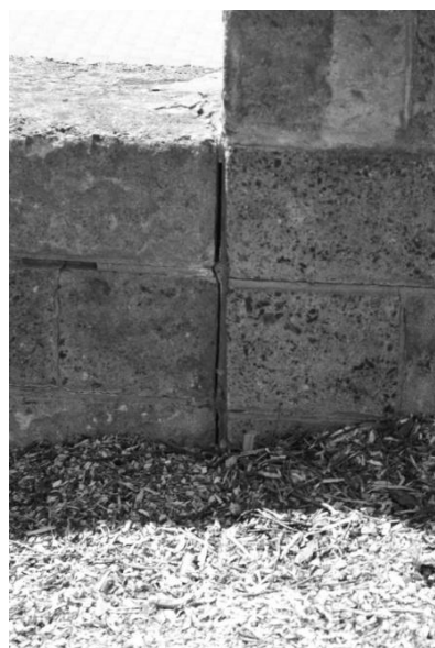
Rys. 5. Odspojenie poprzeczne (zdjęcie: B. Piotrowicz). Fig. 5. Transverse debonding (photo by B. Piotrowicz).
