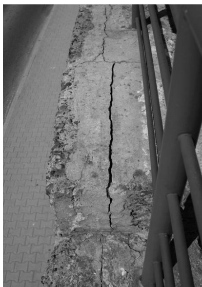
Rys.4. Pęknięcie wzdłużne (zdjęcie: B. Piotrowicz). Fig. 4. Longitudinal crack (photo by B. Piotrowicz).
