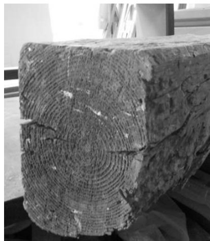
Rys. 2. Widok uszkodzeń elementu przeznaczony do badania Fig. 2. View of damage of the element intended for testing
